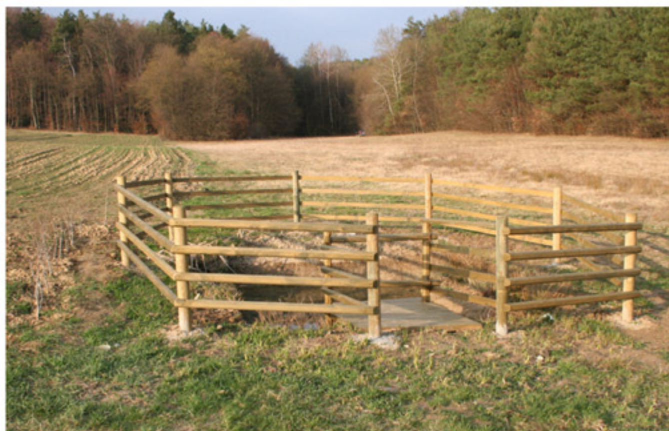
Po ureditvi mlake smo okrog postavili ograjo, da smo zagotovili ustrezno varnost. (Foto: Kikec, april 2007.)
